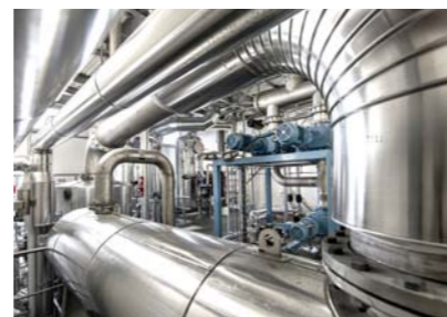
Komplexe Rohrleitungssysteme | Complex piping systems
