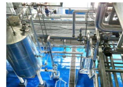
Teil der Prozessanlage | Part of the process plant
