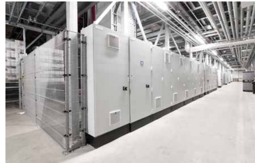
Schaltschranksysteme, Kompetenzzentrum BT-Anlagenbau Control cabinet systems, BT plant engineering competence center
