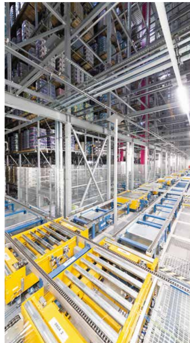
Kettenförderanlage in einem errichteten Hochregallager, Kompetenzzentrum ECE-LOG / AAT Chain conveyor system in an erected high-bay warehouse, ECE-LOG / AAT competence center
